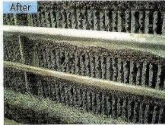
1ヶ月後、Soraの処理システムにより、 藻がすっかり無くなった クーリングタワー充填材
